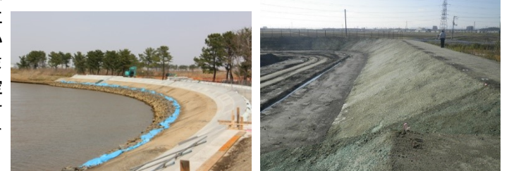
写真 3 五間堀川の護岸工事 写真 4 繊維質固化処理土を用いた遊水池の堤防
